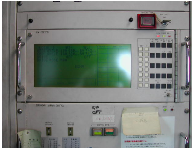
図 3: 三菱制御システム CONTROL パネル
