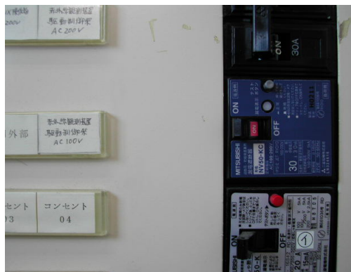
図 11: 三菱制御システムブレーカー
